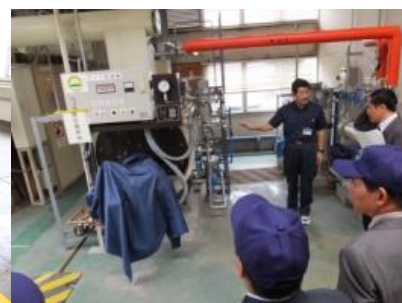
【図 42 ビル設備について】
