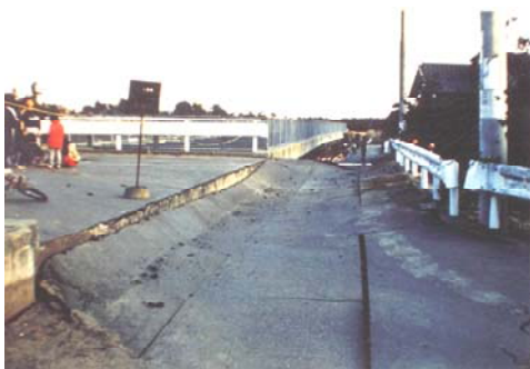
下水道掘り返し部分の液状化沈下 （写真提供：千葉県環境研究センター）
