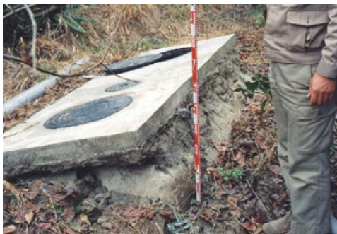
液状化－流動化被害：重いもの沈む 軽いもの浮く
