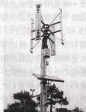
設置された風力発電機
